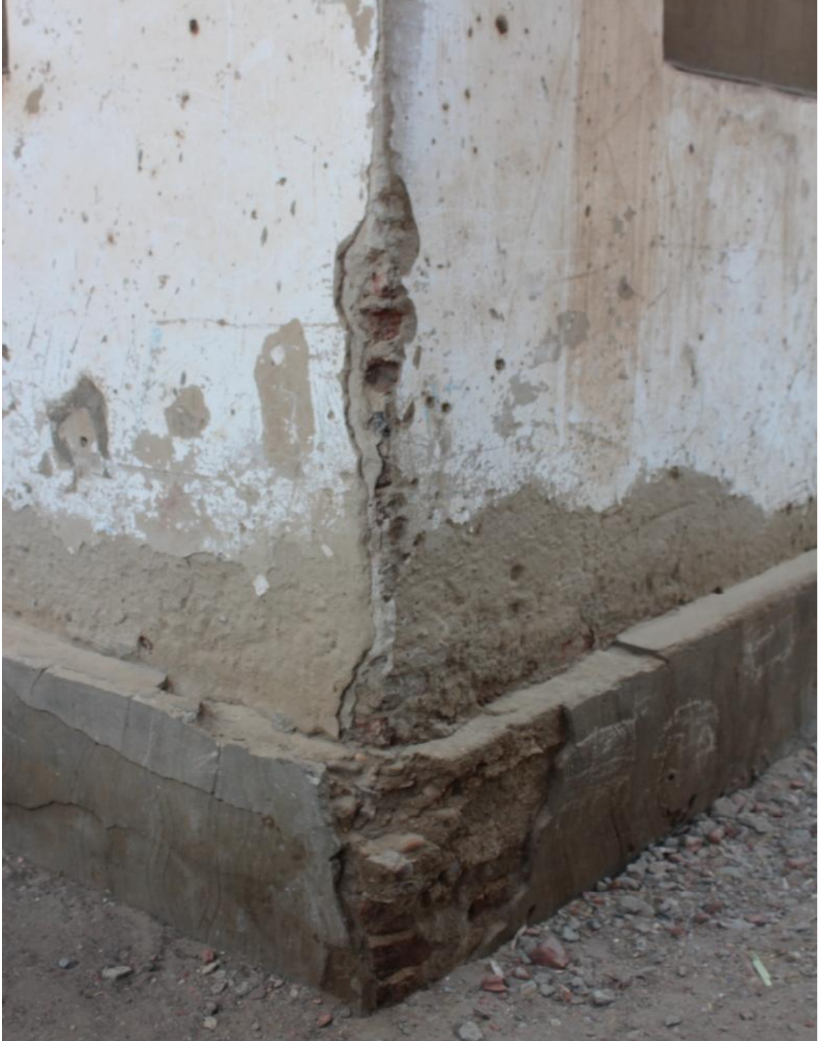
تصدع المباني بسبب مياه الصرف الصحي (تصوير: مصعب شحرور، المركز المصري للحقوق الاقتصادية والاجتماعية)
